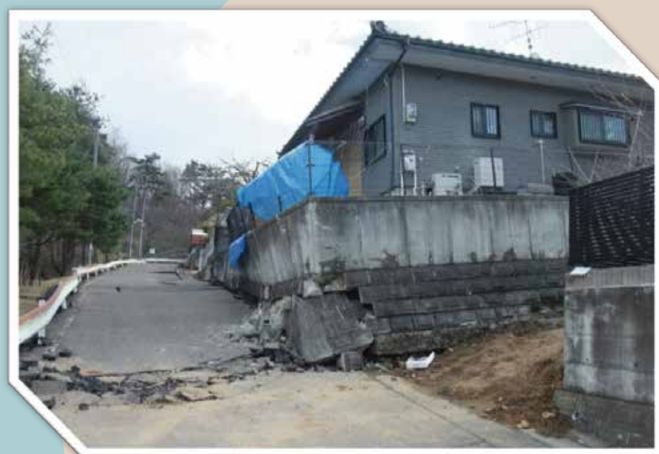
※盛土造成地の変状による住宅の被害（東日本大震災）
